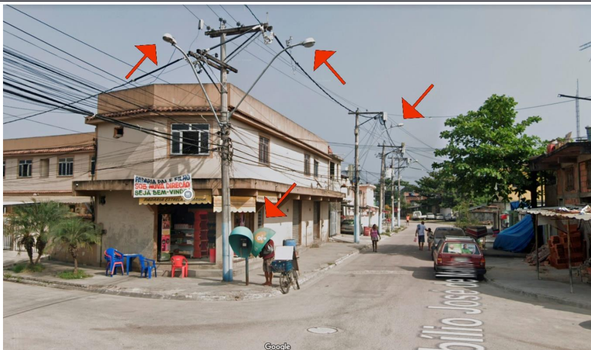
POSTE DE ILUMINAÇÃO E TELEFONE PÚBLICO.
